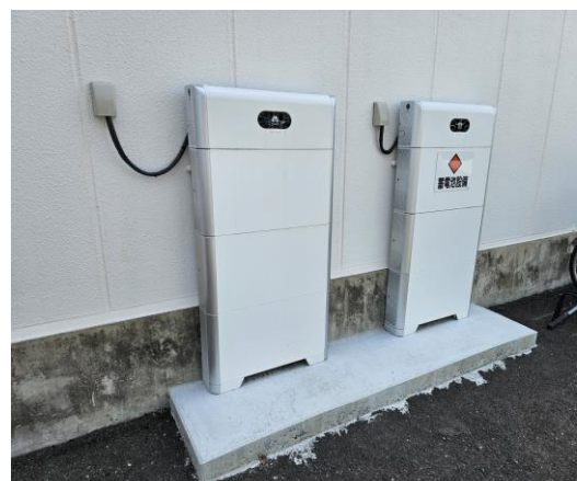
【太陽光発電装置蓄電池写真】
