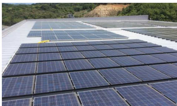
【工場屋上設置の太陽光パネル写真】
